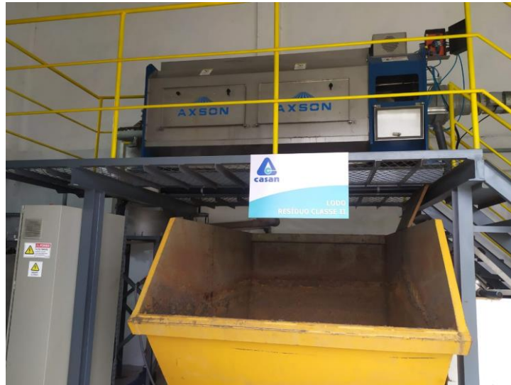
Figura 4 – Filtro prensa da ETE Nações
